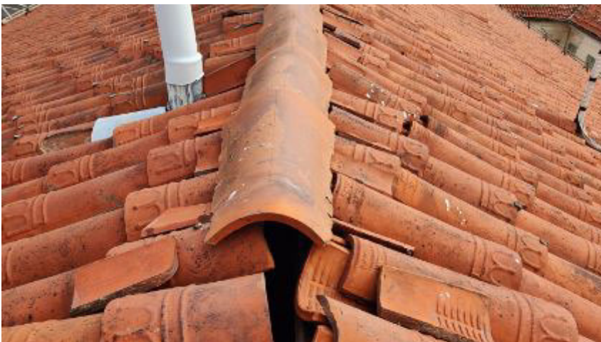
Le attuali condizioni del tetto di Palazzo Natta
