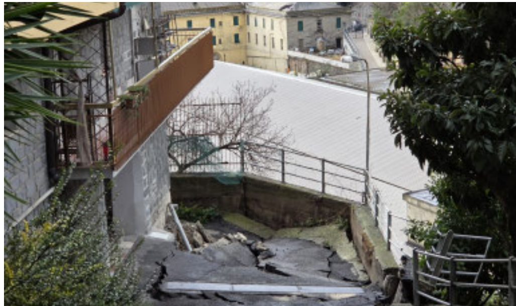
La frana di via Napoli vista dalla parte alta del palazzo che è stato evacuato
