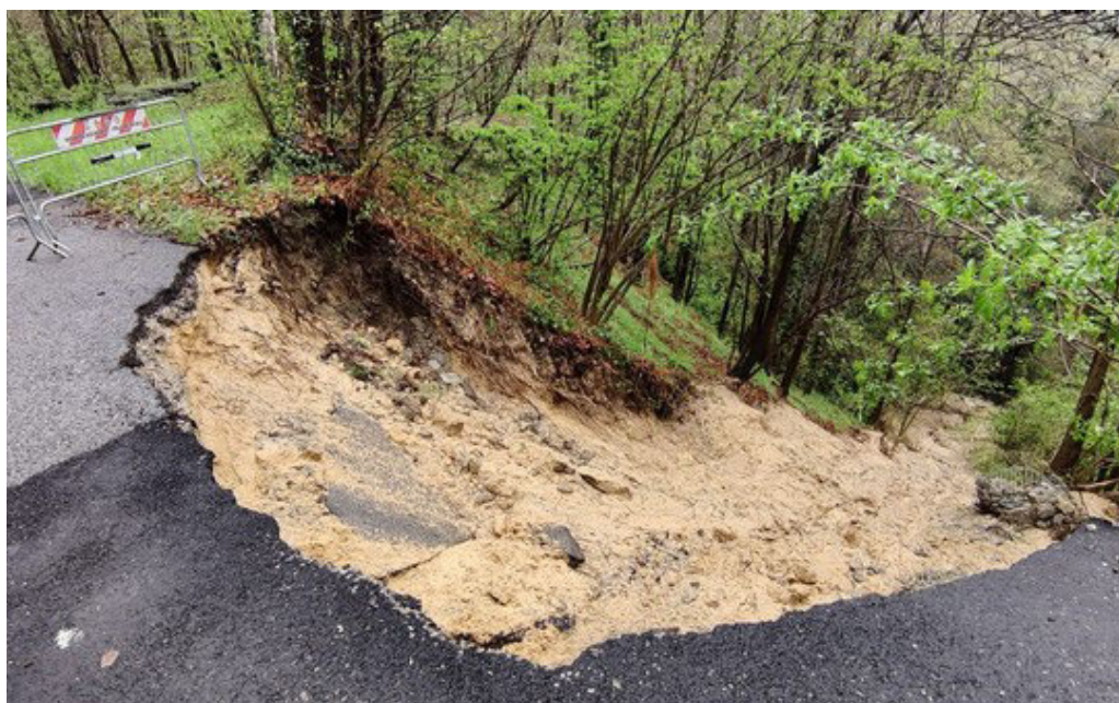
Frane e allagamenti hanno interrotto diverse strade in Valbormida
