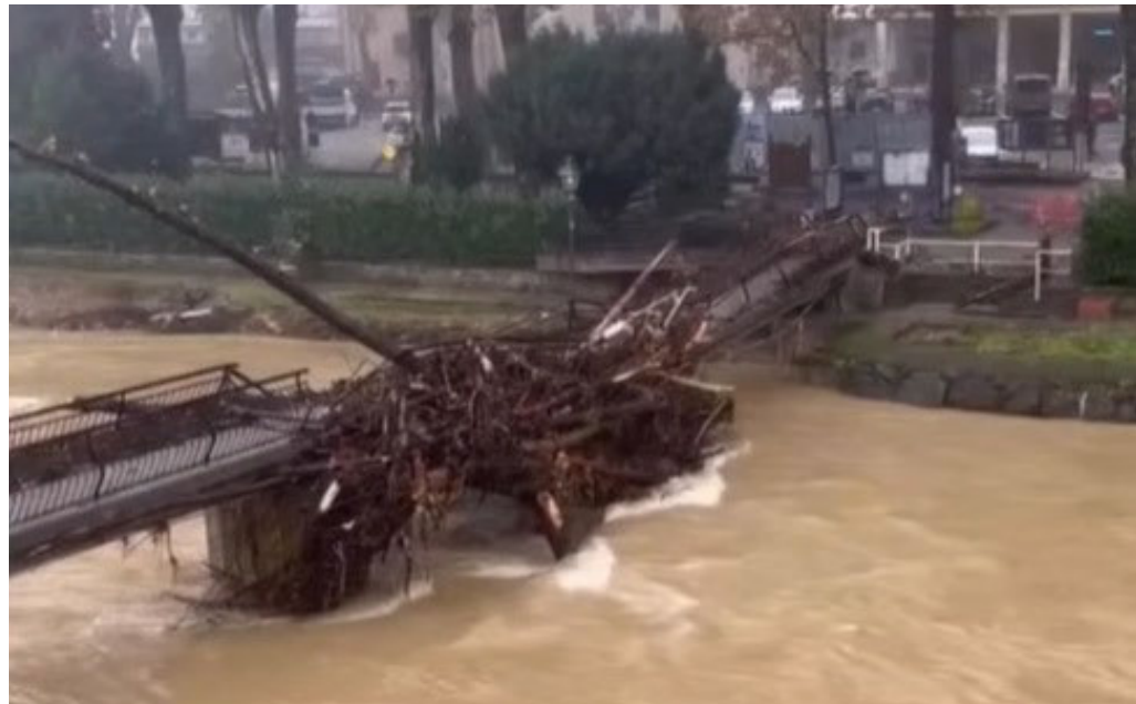
L'ondata di maltempo dello scorso settembre ha provocato diversi danni
