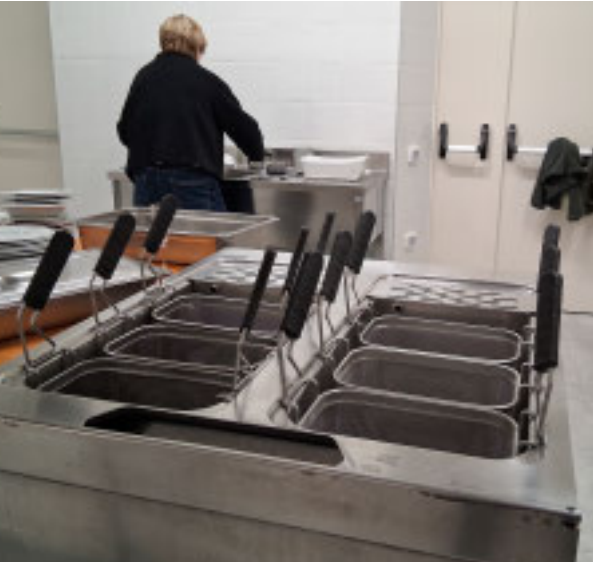
Una porzione della nuova cucina inaugurata alla Bertello
