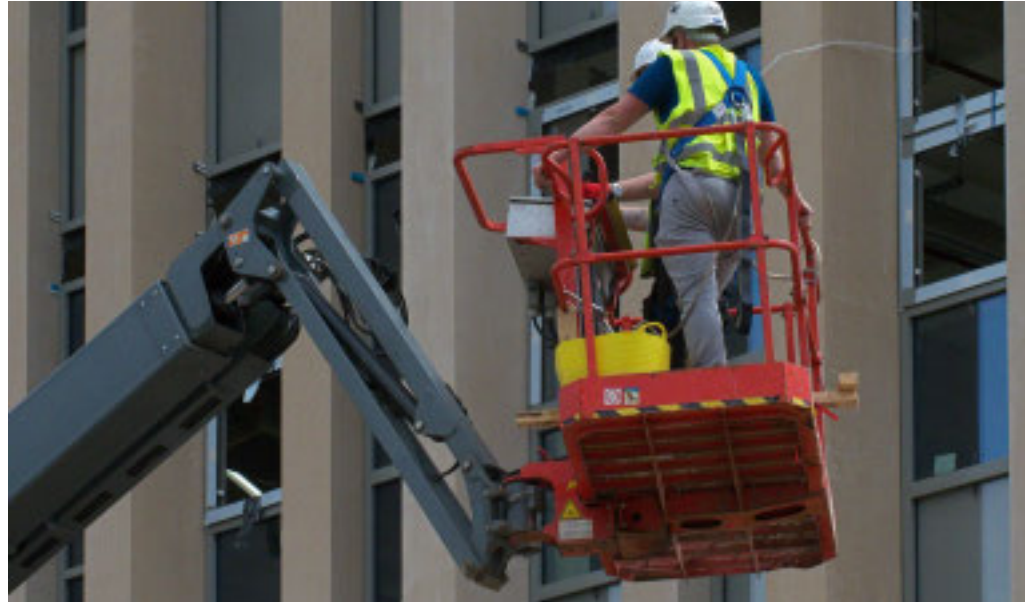
Con bollettini di temperature ad alto rischio i lavoratori all'aperto si fermeranno dalle 12.30 alle 16
