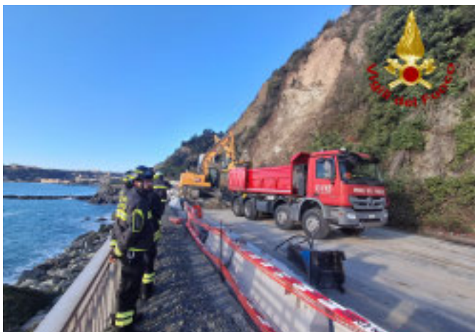
ARENZANO Il tratto dove è avvenuta la frana
