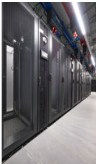
L'INTERNO del Data Center
